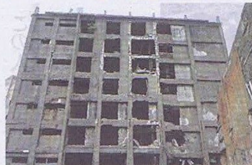
鉄筋の腐食で崩壊が進む躯体 (端島)
